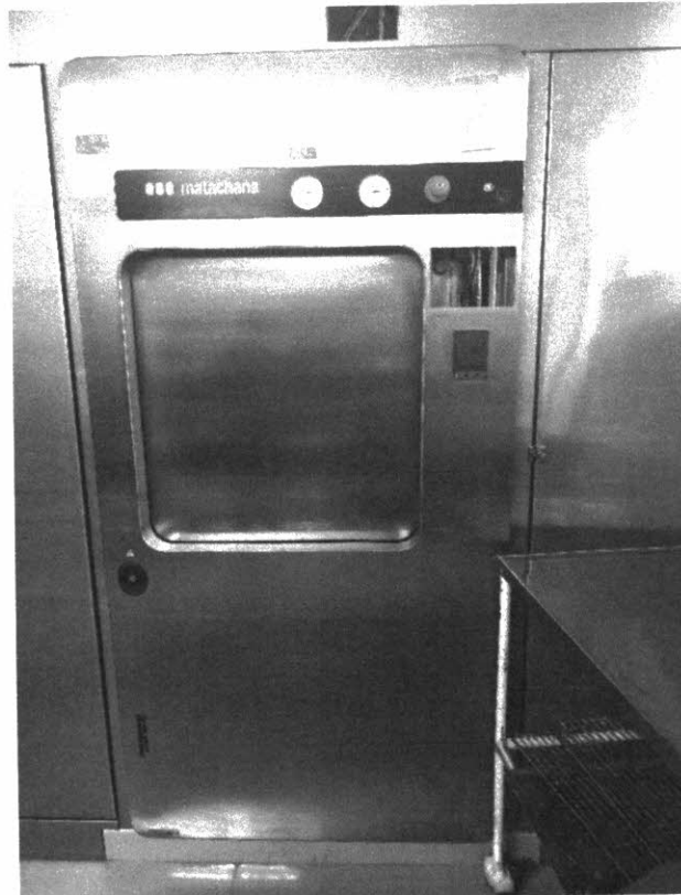
Fotografía 04: Situación de esterilizador a vapor inoperativo
